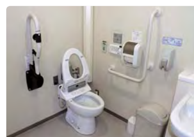
バリアフリー化した西日本支社のトイレ
