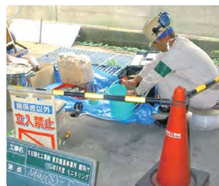
地下水のモニタリング
