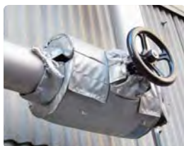
保温強化した蒸気配管
