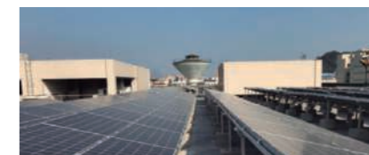
日本、中国、タイの製造拠点で太陽光発電設備が稼働中
