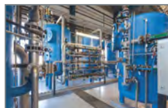
排水浄化・水処理
